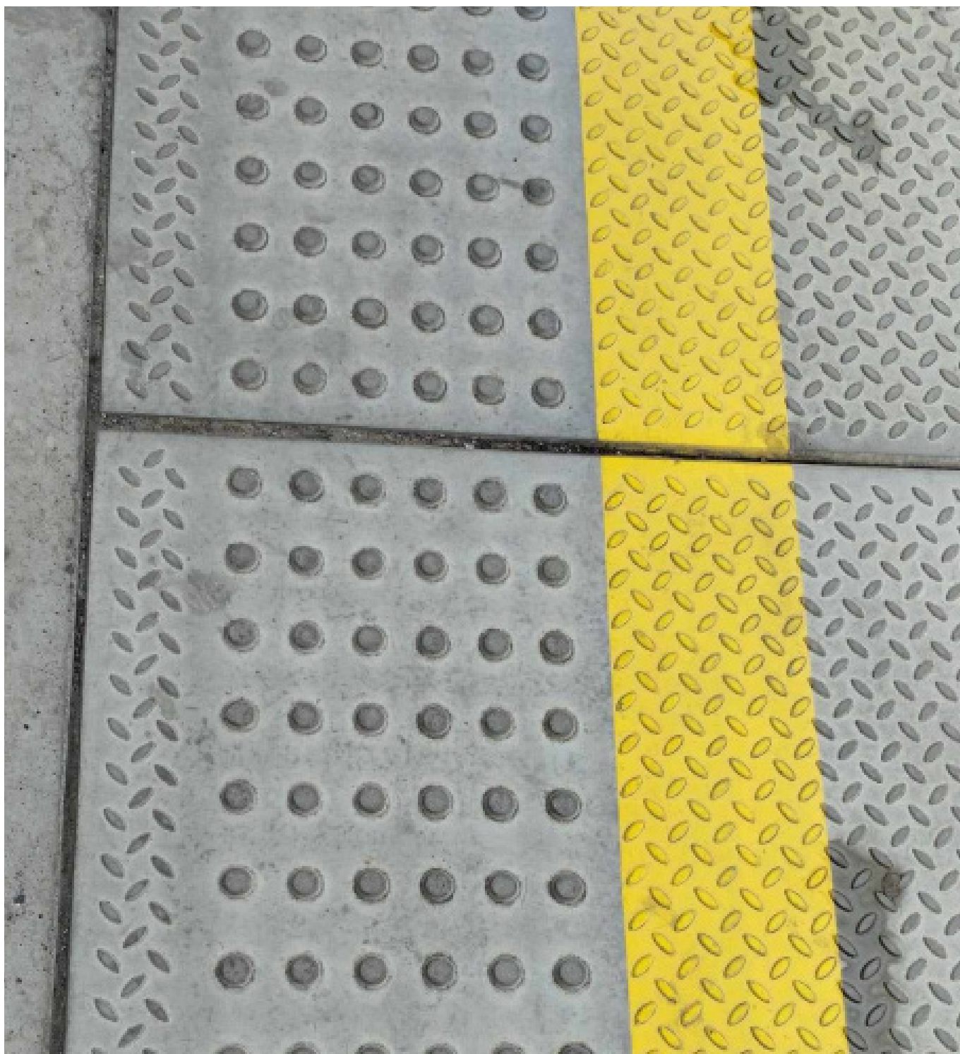
Zdjęcie 28: Linia prowadząca na stacji kolejowej Myszków ułożona jest do góry nogami.
