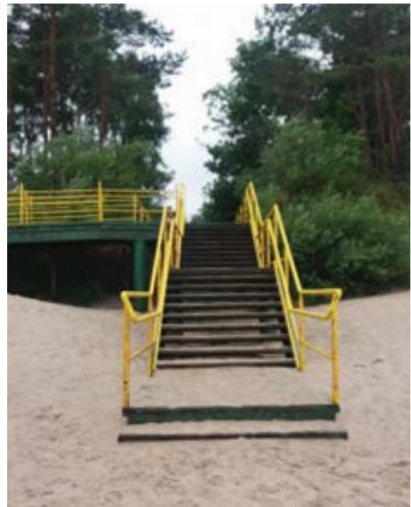
Schody z obustronnymi poręczami, zamontowanymi na dwóch wysokościach, bez oznaczeń kontrastowych, Mielno
